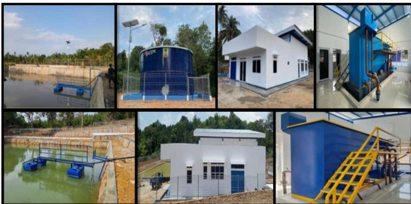
Gambar II.4 Sarana dan Prasarana Air Bersih yang Terbangun
