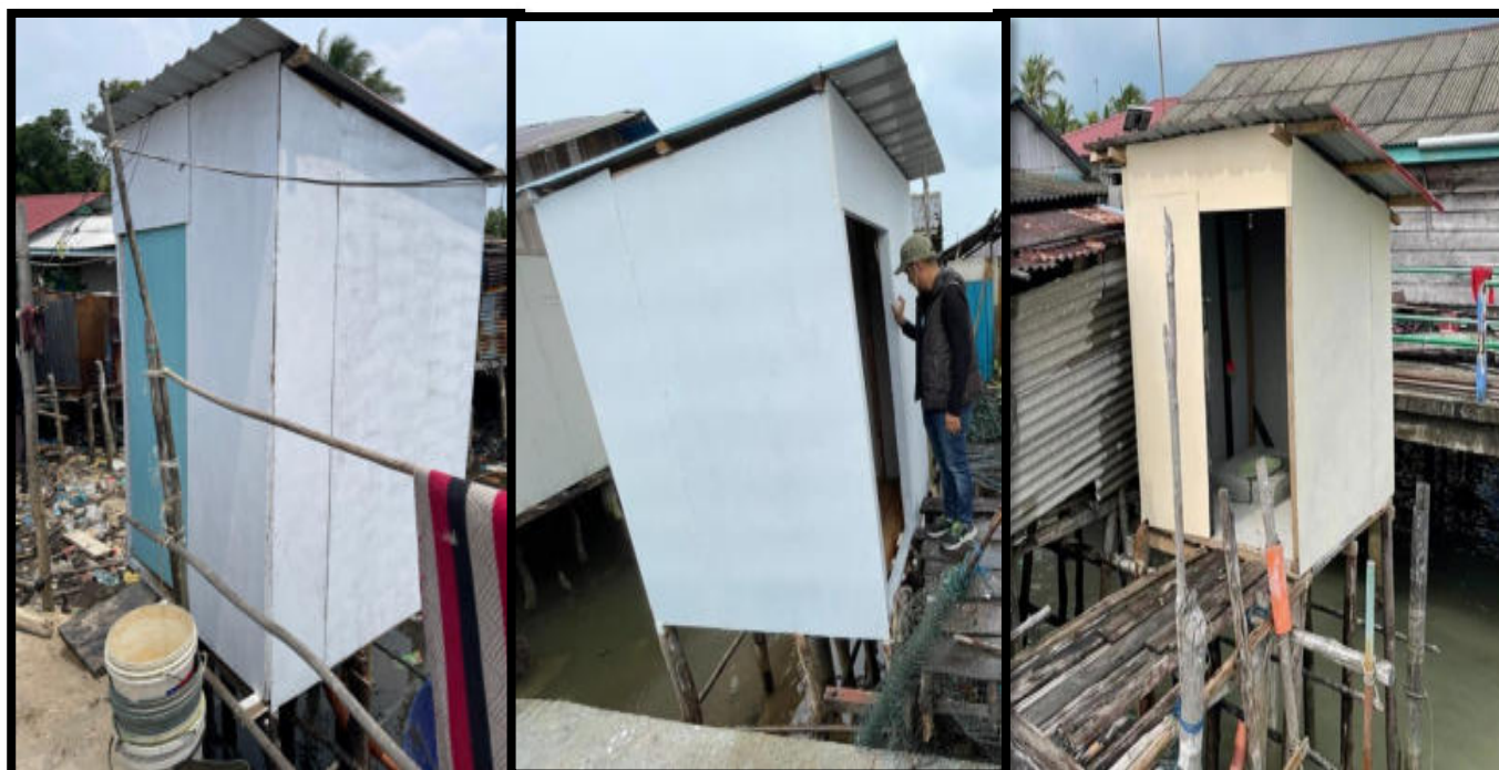
Gambar II.5 Sarana dan Prasarana Air Limbah Domestik yang Terbangun
